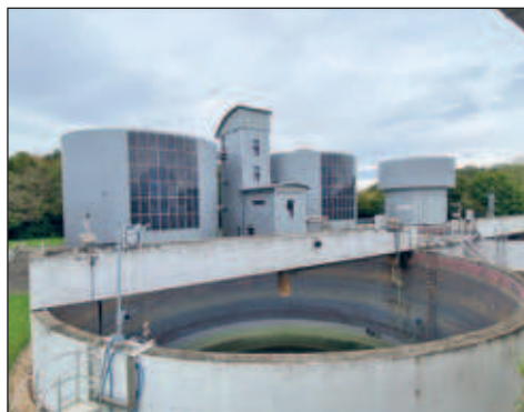
Bild 2: Schlammfäulung – Von Faultürmen und Voreindicker ...
