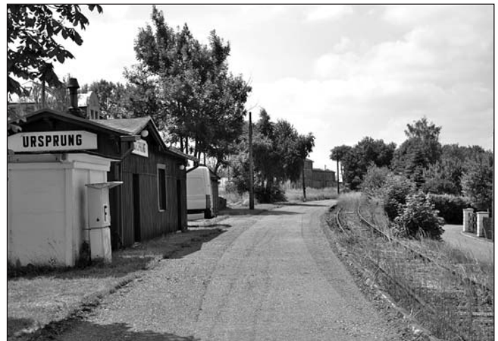
Baustelle des neuen Radweges im Bereich des Haltepunktes Ursprung. Foto: Felix Bochmann
