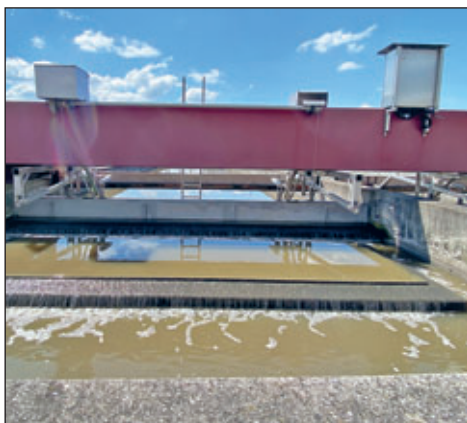
Bild 2: Längsbecken, von denen zwei ständig im Betrieb (Sommer- und Winterbecken) sind
