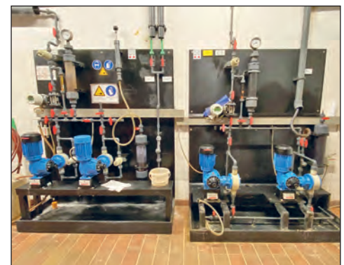
Dosieranlage für Natriumaluminat und Eisen-III-Chlorid mit Dosierpumpen
