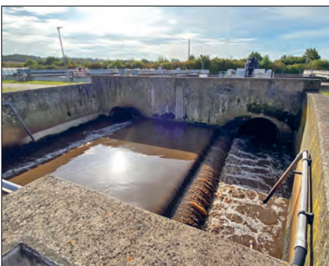
Zuführung von Natriumaluminat Verteilbauwerk Belebungsbecken
