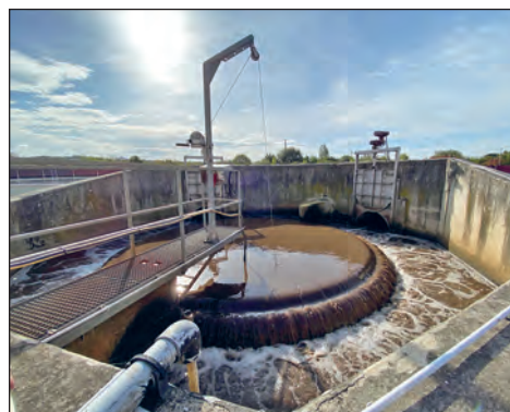
Zuführung von Eisen-III-Chlorid im Verteilbauwerk Nachklärbecken
