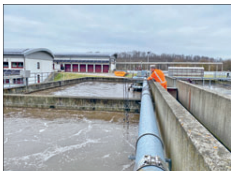
Bild 2: Trotz Mikroorganismen ist rund um die Belebungsbecken viel energieintensive Technik im Einsatz
